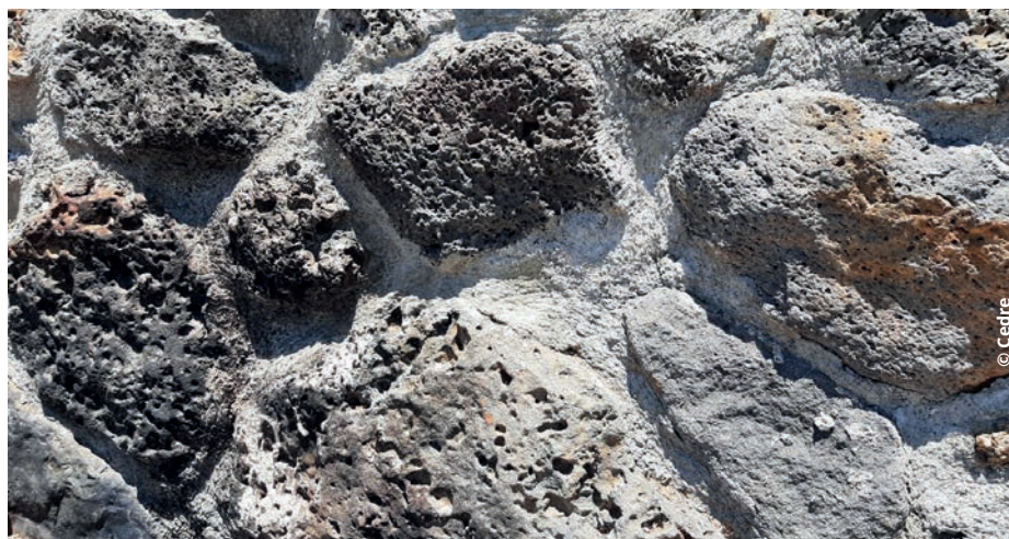
^ Vérification de l'absence de polluant remobilisable ou susceptible d'entraîner des salissures, par frottement, sur la surface ou dans les anfractuosités/porosités d'une structure portuaire (ici : mur en pierres jointoyées traité par rinçage et par nettoyage final par haute pression)
