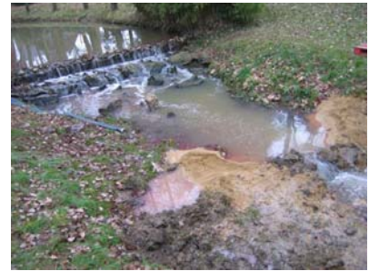
Barrage de sable effondré (Source : Ltn. Langlois - SDIS 44)
