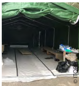
Exemple d'équipement sur un site de nettoyage
